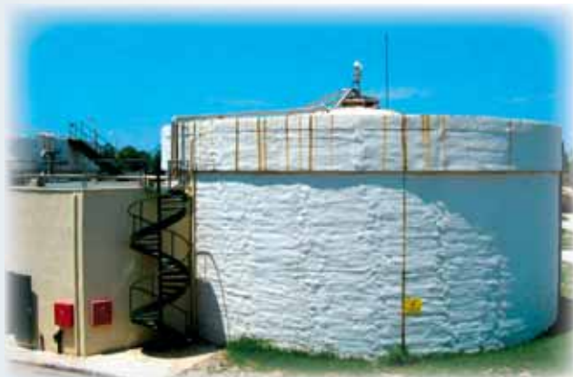
↑ Εικόνα 5: ΚΕΛ Λάρισας. Άποψη δεξαμενών ανασρόβιας χώνευσης. [Φωτ.: Αργ. Παπακωνσταντίνου]
