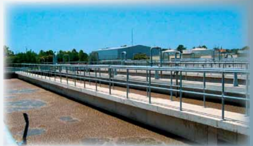
↑ Εικόνα 3: ΚΕΛ Λάρισας. Άποψη δεξαμενών αερισμού. [Φωτ.: Αργ. Παπακωνσταντίνου]
