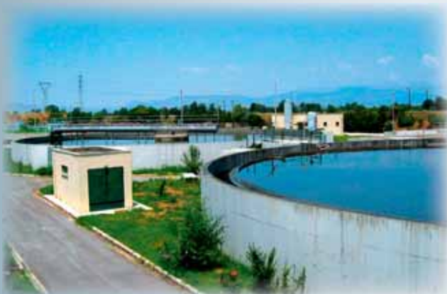
↑ Εικόνα 4: ΚΕΛ Λάρισας. Άποψη δεξαμενών δευτεροβάθμιας καθίζησης. [Φωτ.: Αργ. Παπακωνσταντίνου]
